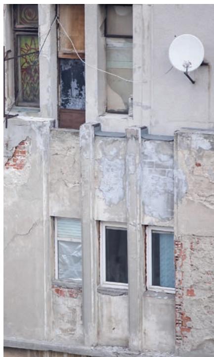
3. Clădire cu risc seismic
